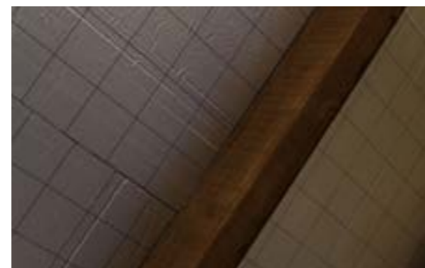
Zdjęcie 05. Wygląd dachu od strony wewnętrznej bez pełnego deskowania. Wymaga to wykończenia na przykład suchym tynkiem
